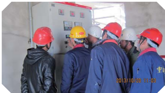
华泰龙公司组织电器设备巡检
