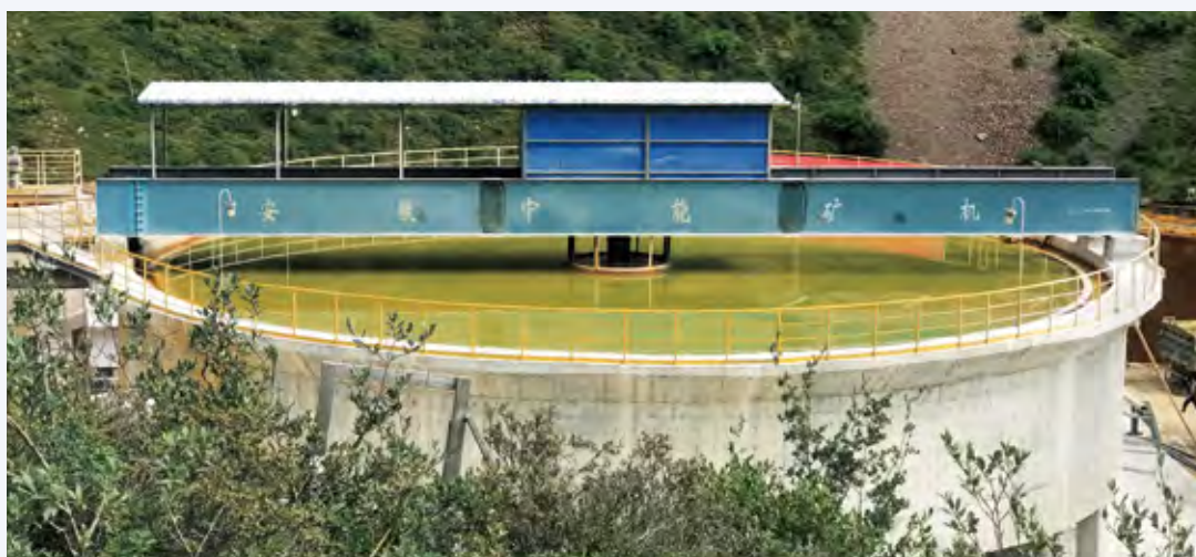
華泰龍公司投資7,200萬元修建的斯布溝酸性山泉水處理廠除鐵沉澱池
