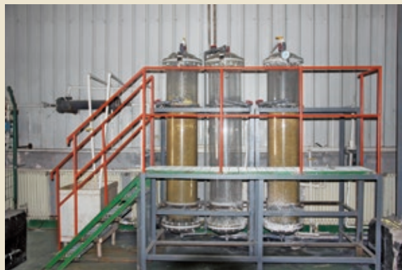
内蒙太平循环液除杂设备
