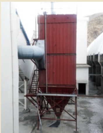
西藏华泰龙二期选厂除尘系统
