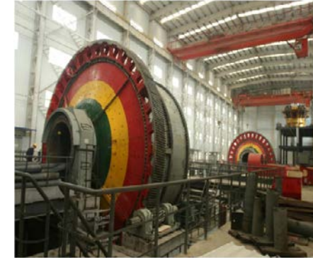
❖ 主要设备已安装
