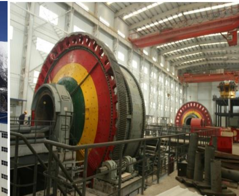
❖ 主要设备已安装
